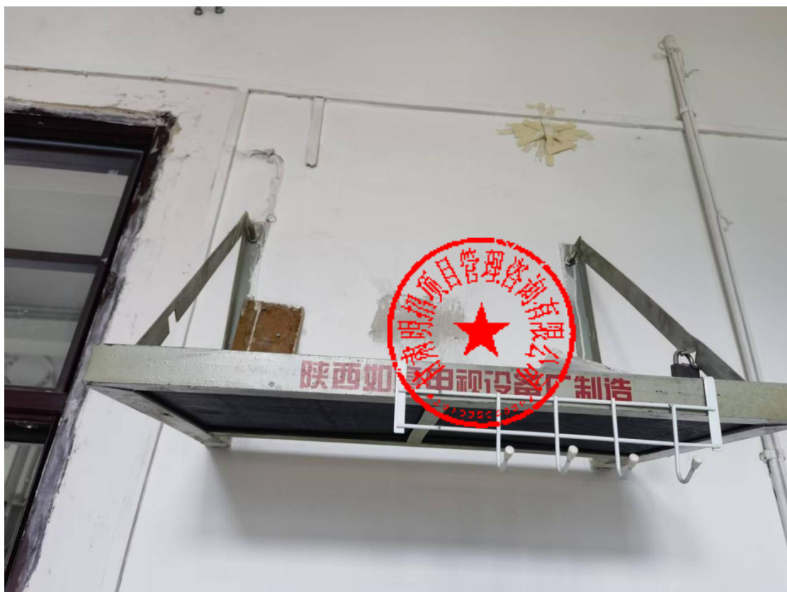
云亭校区 3 号公寓楼电视支架
